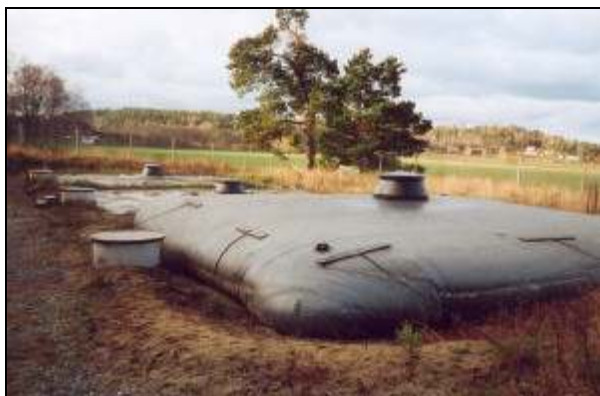
Figur 24. Större ballongtank i presenning av vävförstärkt plast. Stockholm Vattens urinlagringstankar i Bornsjöområdet. (Foto: Ebba af Petersens.)
